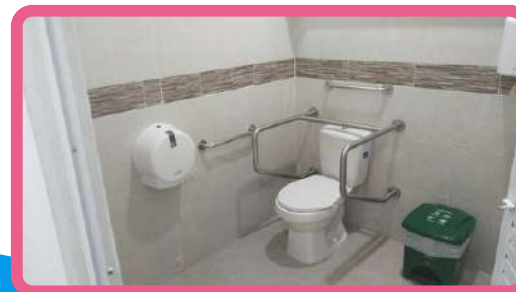
Baño con barandas de soporte
