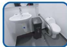
Baño con barandas soporte
