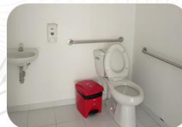
Baño con barandas soporte
