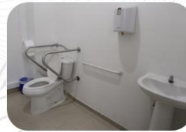
Baño con barandas soporte
