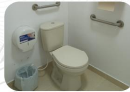
Baño con barandas soporte
