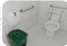
Baño con barandas soporte
