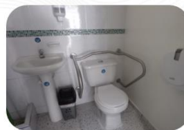
Baño con barandas soporte
