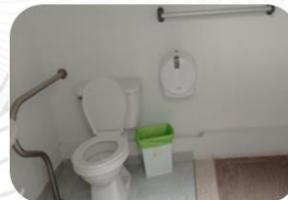
Baño con barandas soporte
