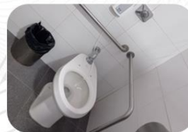
Baño con barandas soporte
