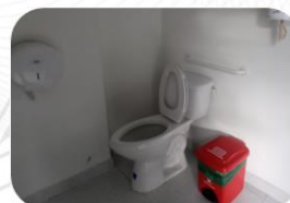
Baño con barandas soporte
