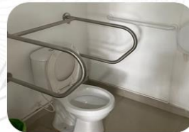
Baño con barandas soporte
