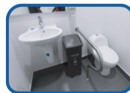
Baño con barandas soporte
